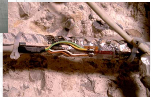
Freigelegter Bewehrungsstahl mit aufgeklebtem Dehnungsmessstreifen
