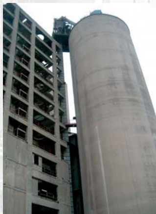
Zementsilo in Dauerüberwachung während des regulären Betriebs
